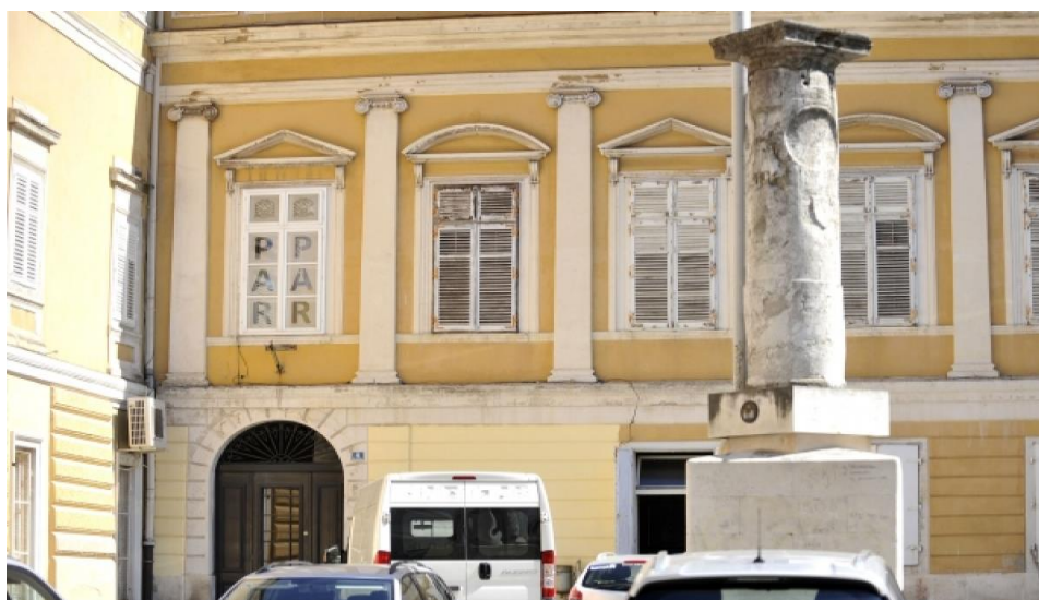
Slika 59. Primjer neugledne instalacije klima jedinice na fasadi javne zgrade
