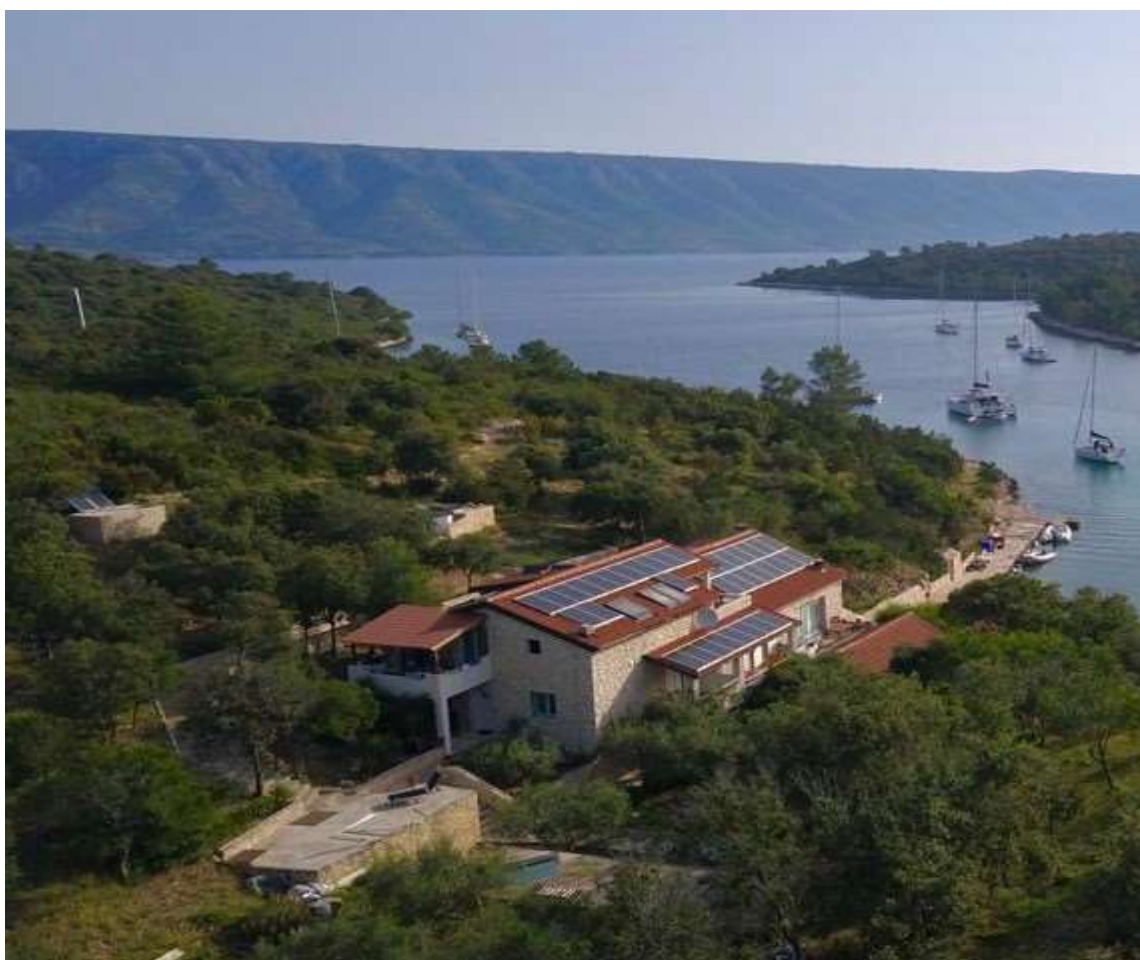
Slika 21. Instalirani fotonaponski sustav na privatnom objektu snage 10 kW IZVOR: Privatna fotografija g. Jakas
